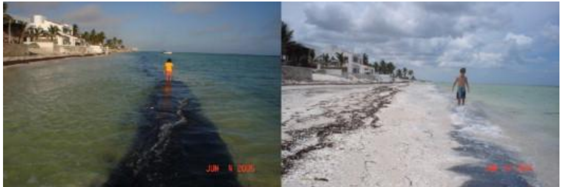
Figura 76. Ejemplo de instalación de un sistema geotextil como rompeolas sumergido y desvinculado de la costa en Yucatán, México. Perfil de playa acumulado entre junio de 2005 (izq) y julio de 2006 (der). Fuente: Álvarez et al. (2007).
