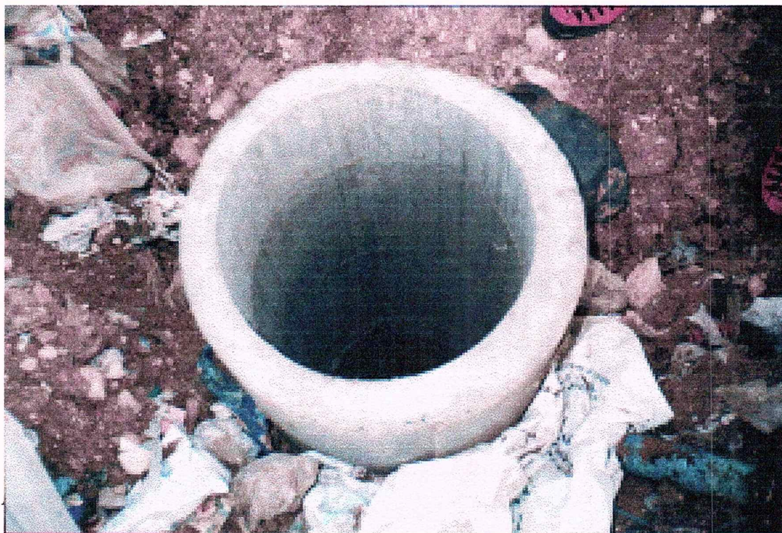
Tubo de extracción de lixiviados.
